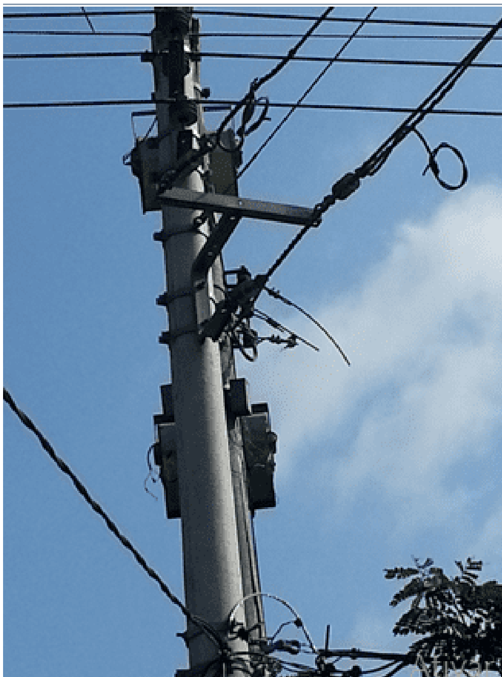
Figura 05 – Condutores da rede space cable para conexão a rede energizada do CFAP.
