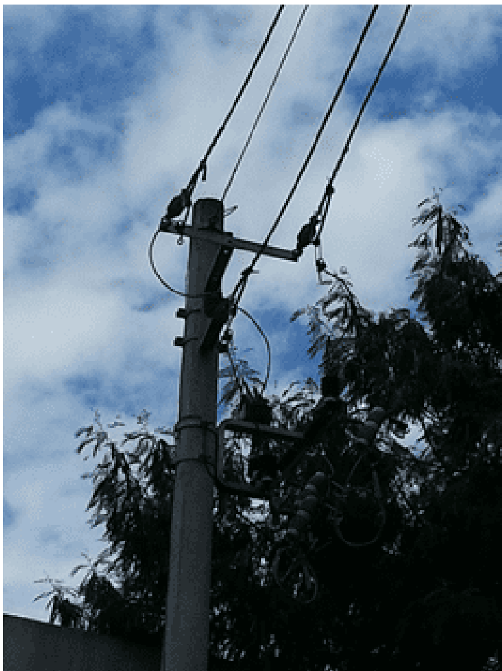
Figura 02 – Ponto de Conexão para a alimentação da rede de M.T a ligar a SE Simplificada de 150 KVA.
