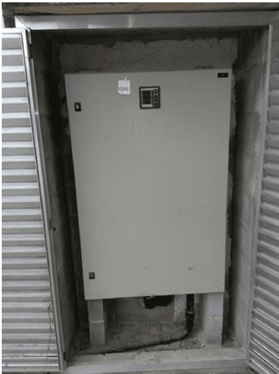
Figura 10 - Disjuntores parciais e proteção geral do QGBT
