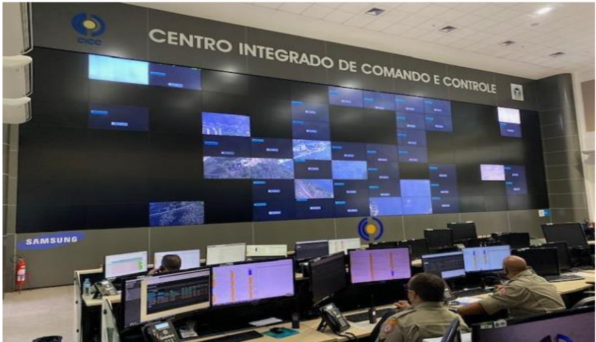
Painel composto de 98 monitores de 55 pol.
