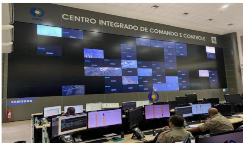
Painel composto de 98 monitores de 55 pol.
