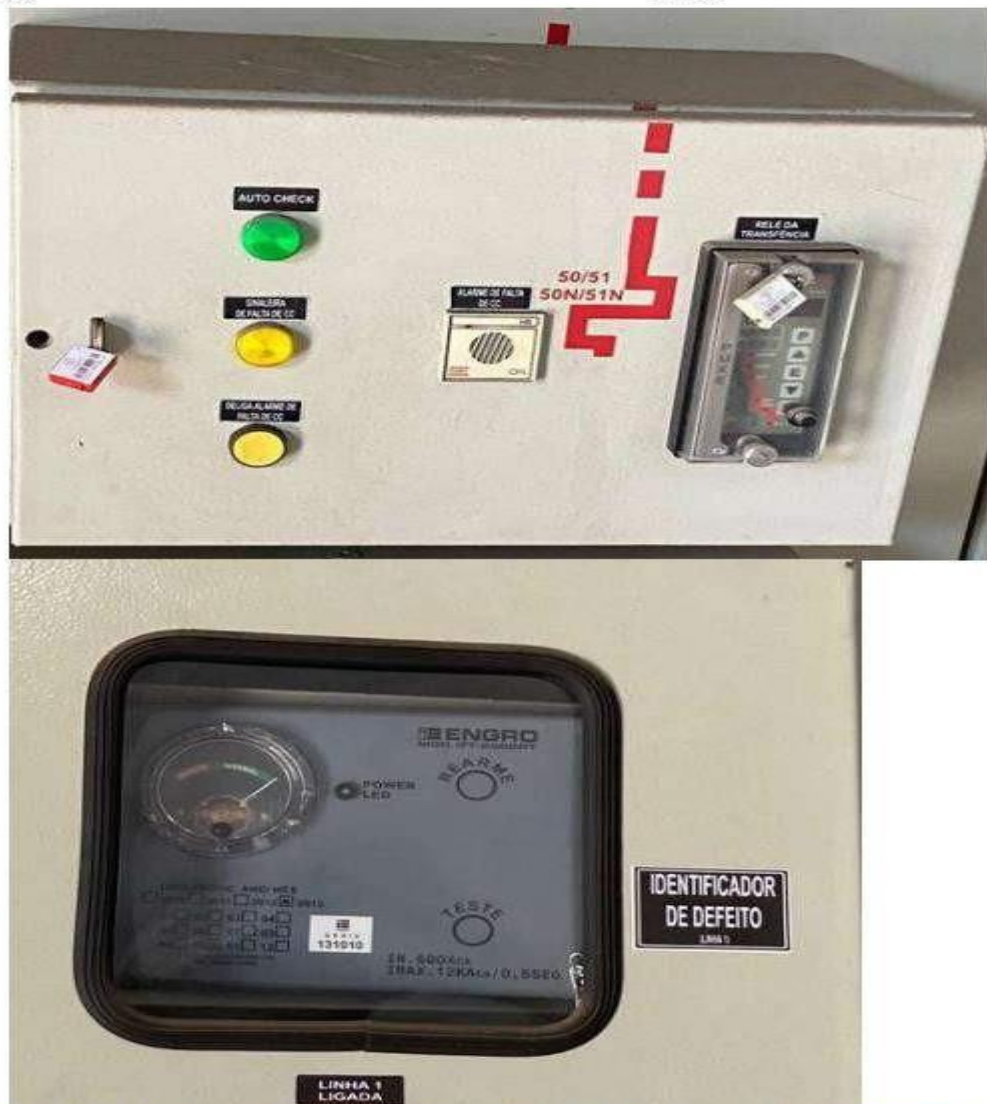
Figura 1, 2, 3 e 4 – Sistema de Proteção, DTAC e Identificadores de Defeito inoperante;
