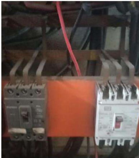
Figura 02 – Espaço vago no QGBT.
