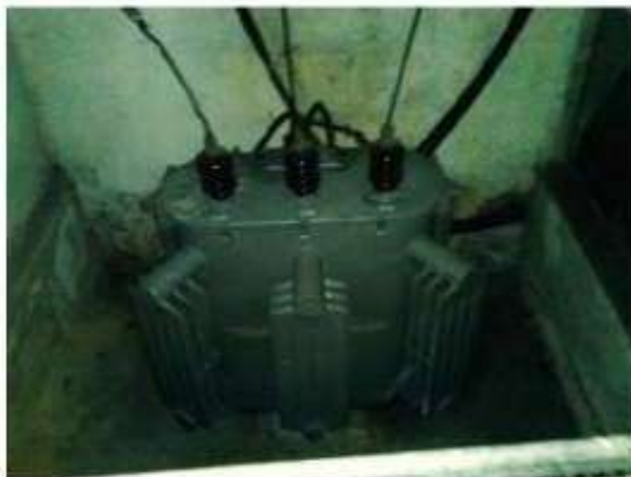
Figura 02 – Transformador a óleo com potência de 112,5 KVA, assentado no chão, que fornece atualmente energia elétrica em Baixa Tensão (B.T) para a Caserna General Castrioto.
