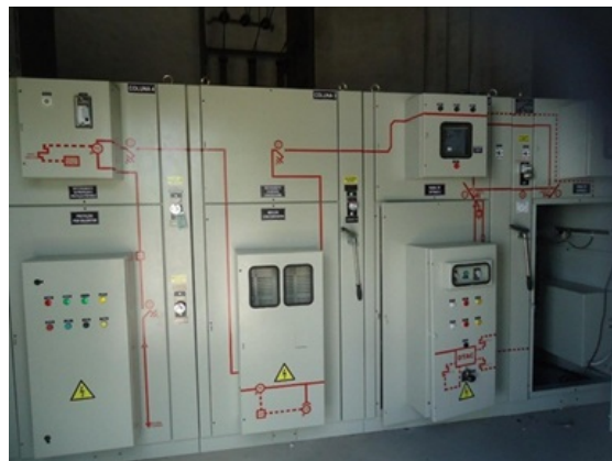
Foto 3 – Subestação Blindada Instalada no CFAP.
