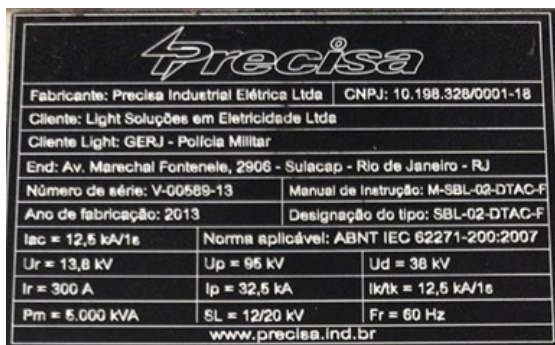
Figura 01 – Placa de identificação da Subestação Blindada de Média Tensão do tipo SBL-02-DTAC-F instalada das dependências do CFAP. Fotografia feita in loco.
