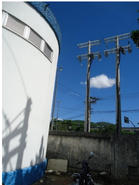
Foto 02 - Dois ramais de M.T de entrada da concessionária.
